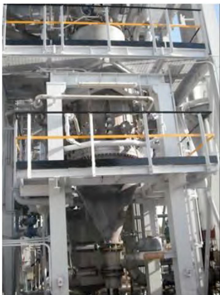
Figura 2. Gassificatore impianto dimostrativo
