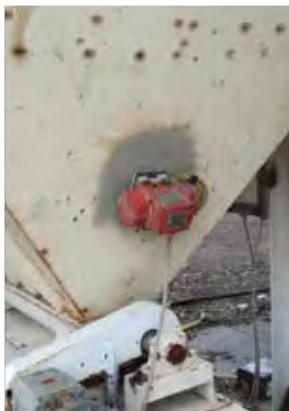
Figura 14. Vibrovaglio installato sulla tramoggia del Redler
