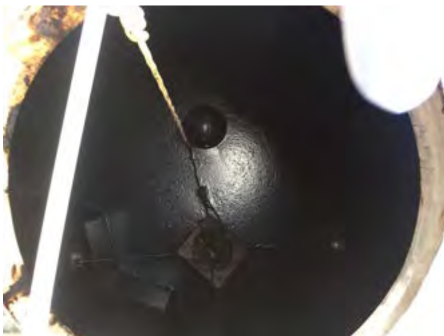
Figura 16. Scolmatore installato nel Tank Scrubber
