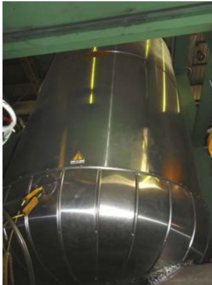
Fig. 2—6 – S3V dump tank.
