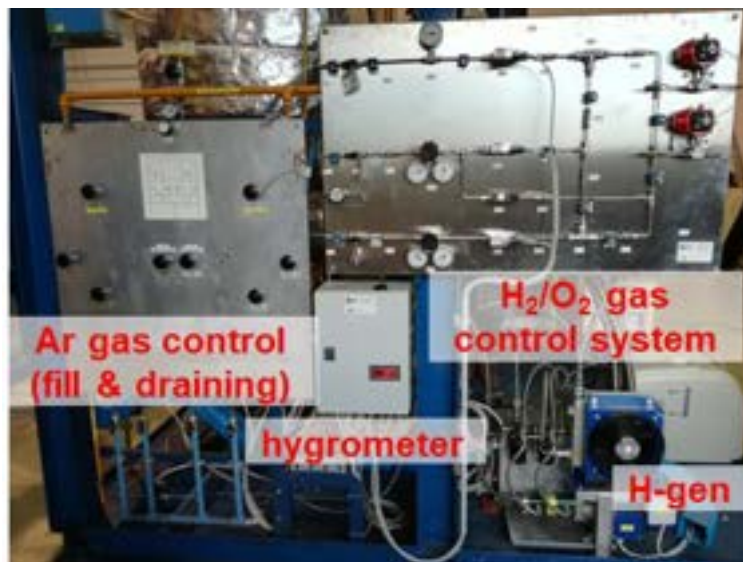
Figura 13: Sistema di controllo gas che include il sistema di caricamento (fill & draining), il generatore di idrogeno (H-gen), il sistema di iniezione delle miscele Ar-H 2 e Ar-O 2 e l'igrometro nella linea gas in uscita dal serbatoio di stoccaggio.
