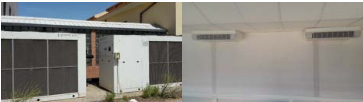
Foto 3.9. Centrale Impianto di condizionamento, unità esterne e fancoil
