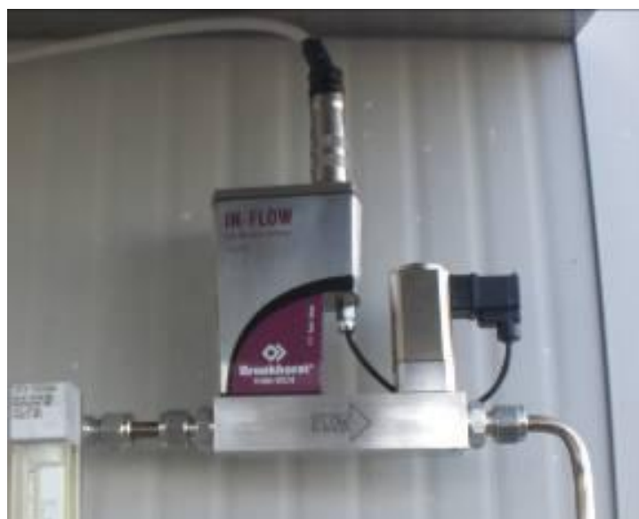
Figura 6 – Regolatore e rilevatore della portata dell'idrogeno
