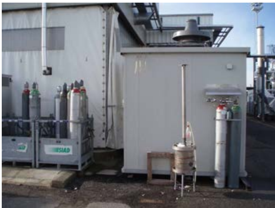
Figura 4 – Locale dove è sistemata la cella MCFC
