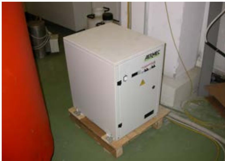
Fig. 13 – Pompa di calore AERMEC 015H
