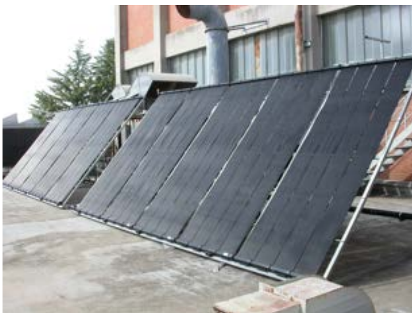
Fig. 17 – Campo solare installato presso il CR Casaccia
