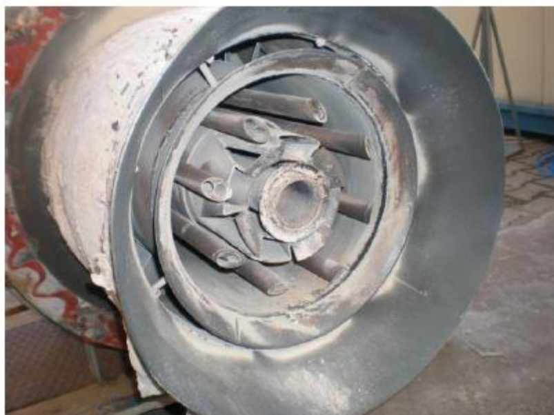
Figura 1.5 – Vista frontale del bruciatore
