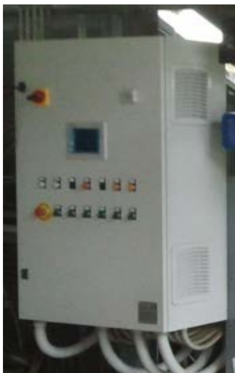
Figura 8: Il quadro elettrico di controllo.
