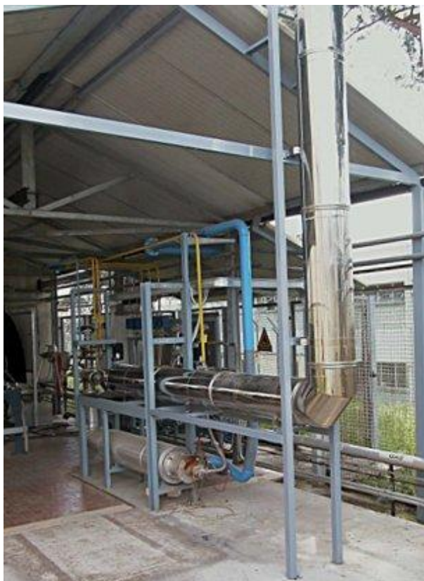
Figura 5: Sistema di evacuazione dei fumi.
