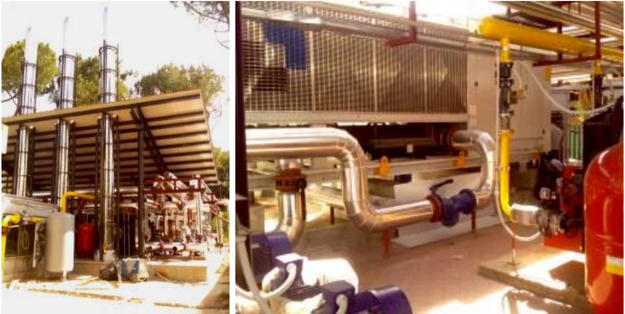
Fig.1.8 – Nuovo polo termo frigorifero che serve l'intero centro sportivo
