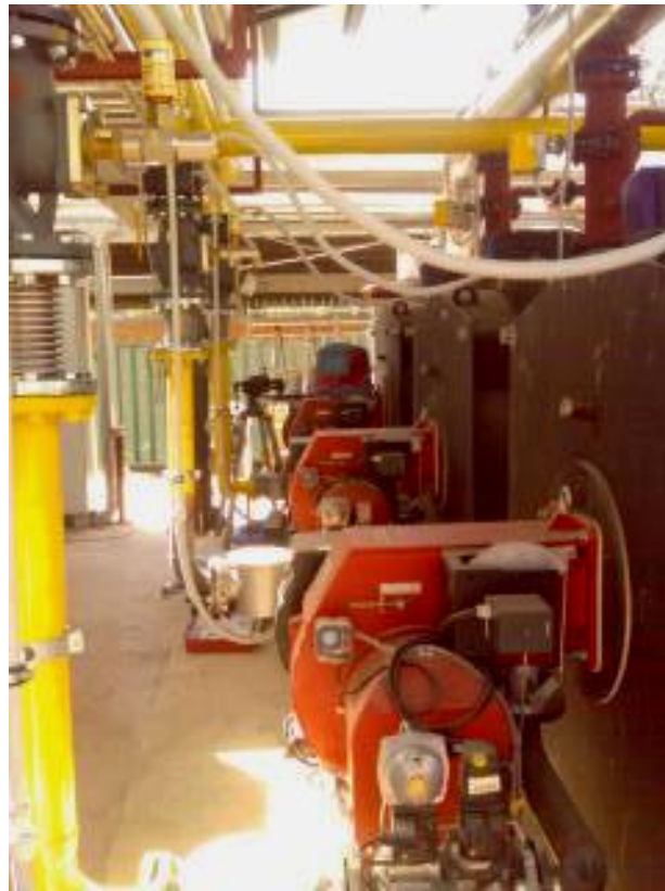
Fig.1.9 – Caldaie a gas del polo termo-frigorifero
