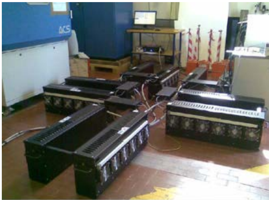
Fig. 22. Impianto di accumulo stazionario della funicolare di Bergamo: prove di collaudo in ENEA
