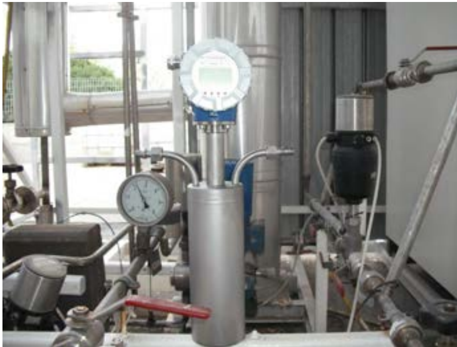
Figura 6. Misuratori di densità di nuova installazione.
