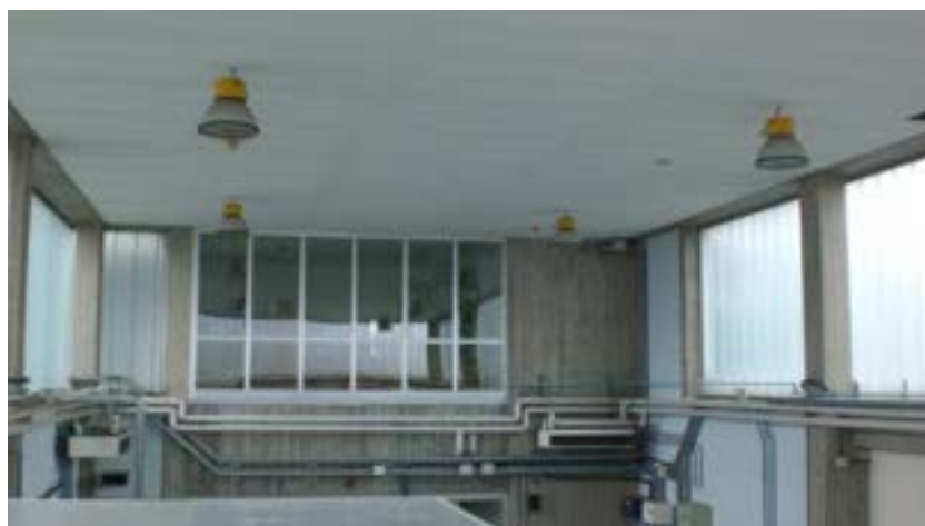
Figura 5: Vista dell'impianto di illuminazione esistente
