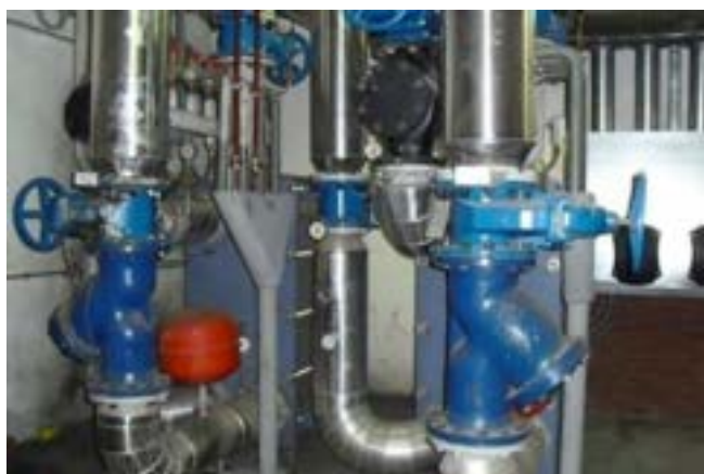
Figura 16 - Scambiatori di calore lato circuito di teleriscaldamento
