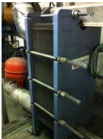
Figura 12: Scambiatore di calore lato circuito palazzina uffici
