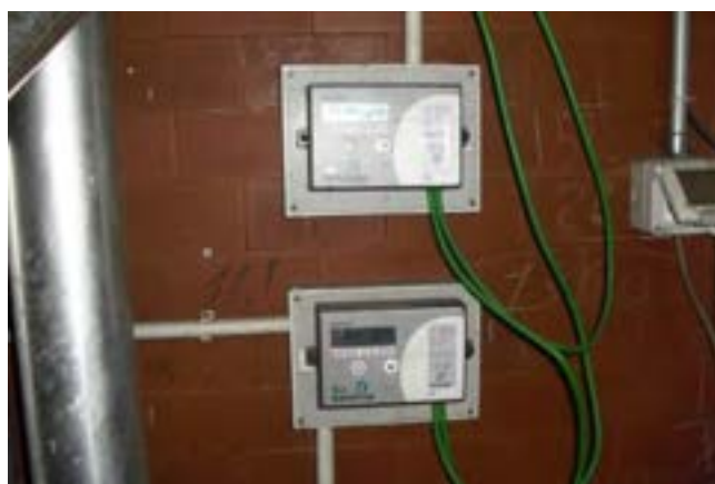
Figura 13: Misuratori nr. 10 e 11
