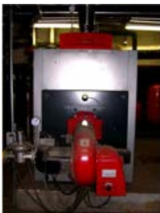
Figura 7 - Caldaia Viessmann Vitocrossal 300 tipo CR3
