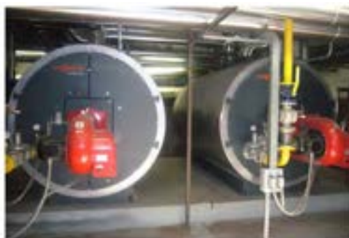
Figura 8 - Caldaie Vitomax 200 tipo M241
