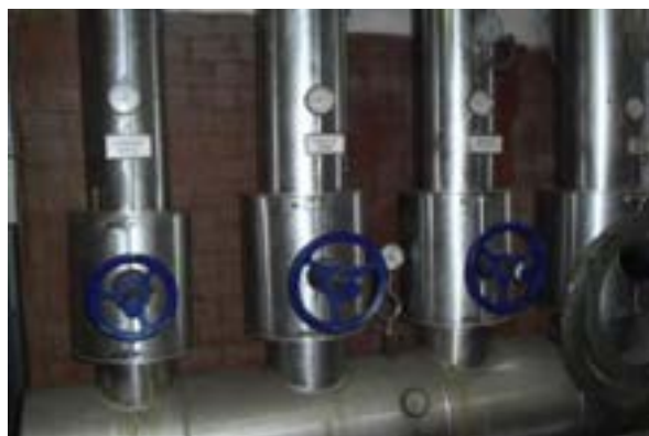
Figura 15: Collettore circuito palazzina uffici
