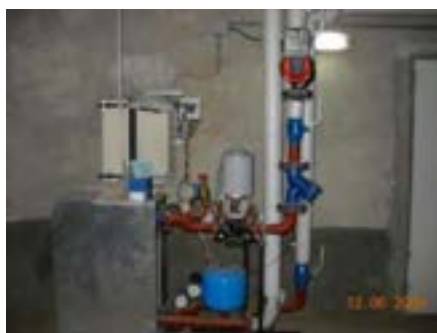
Figura 44 - Piè di stabile con sottostazione di scambio
