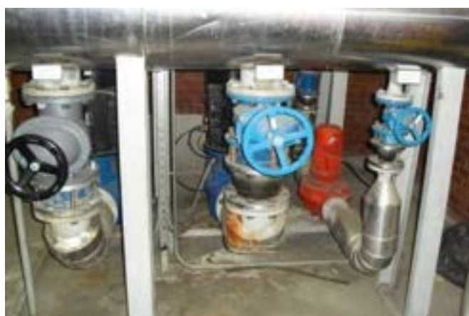
Figura 17 - Pompe del circuito di teleriscaldamento
