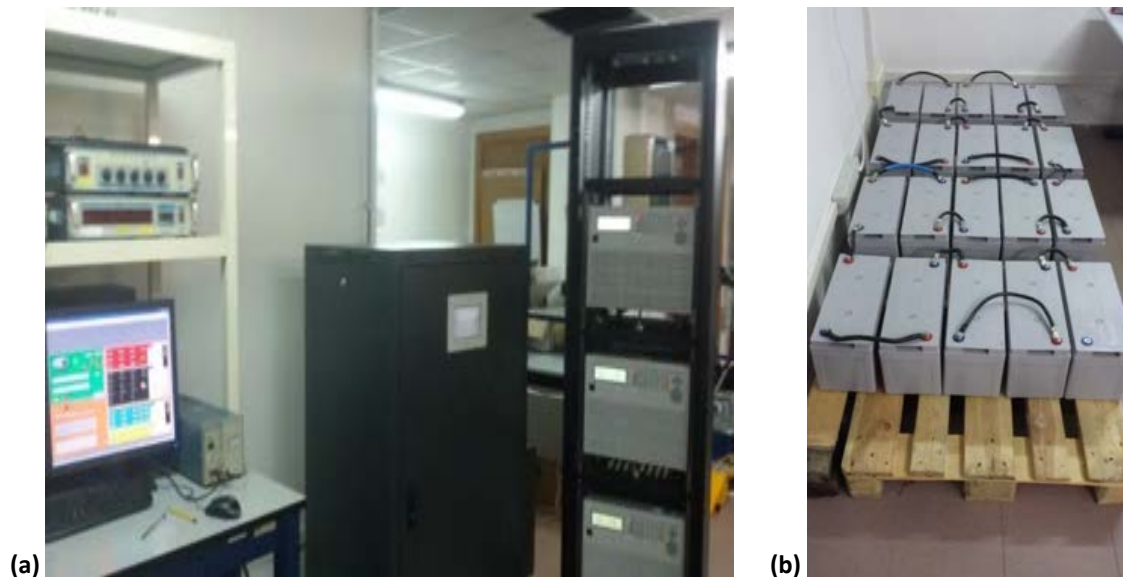
Figura 47 – Impianto sperimentale (a) e sistema di accumulo utilizzati (b)
