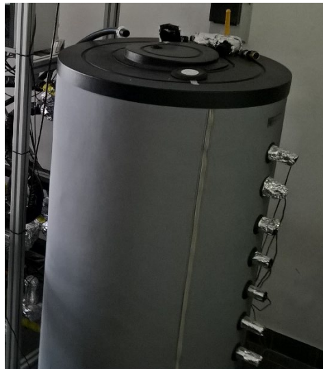
Figura 5. Serbatoio da 400 litri con 120 bottiglie di PCM.
