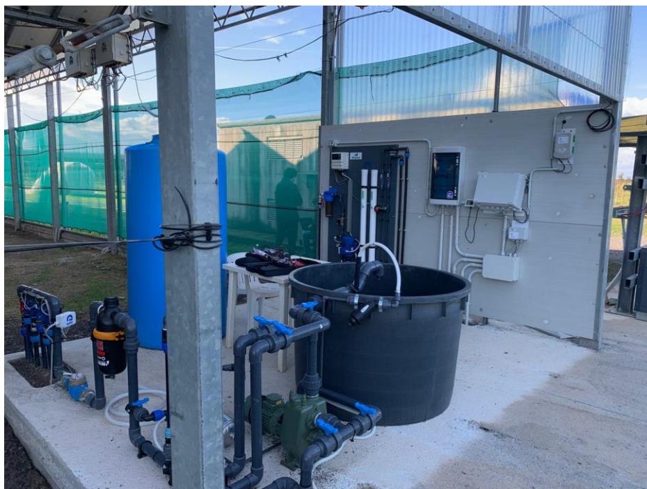
Figura 4- Sistema dissalatore installato presso il sito sperimentale
