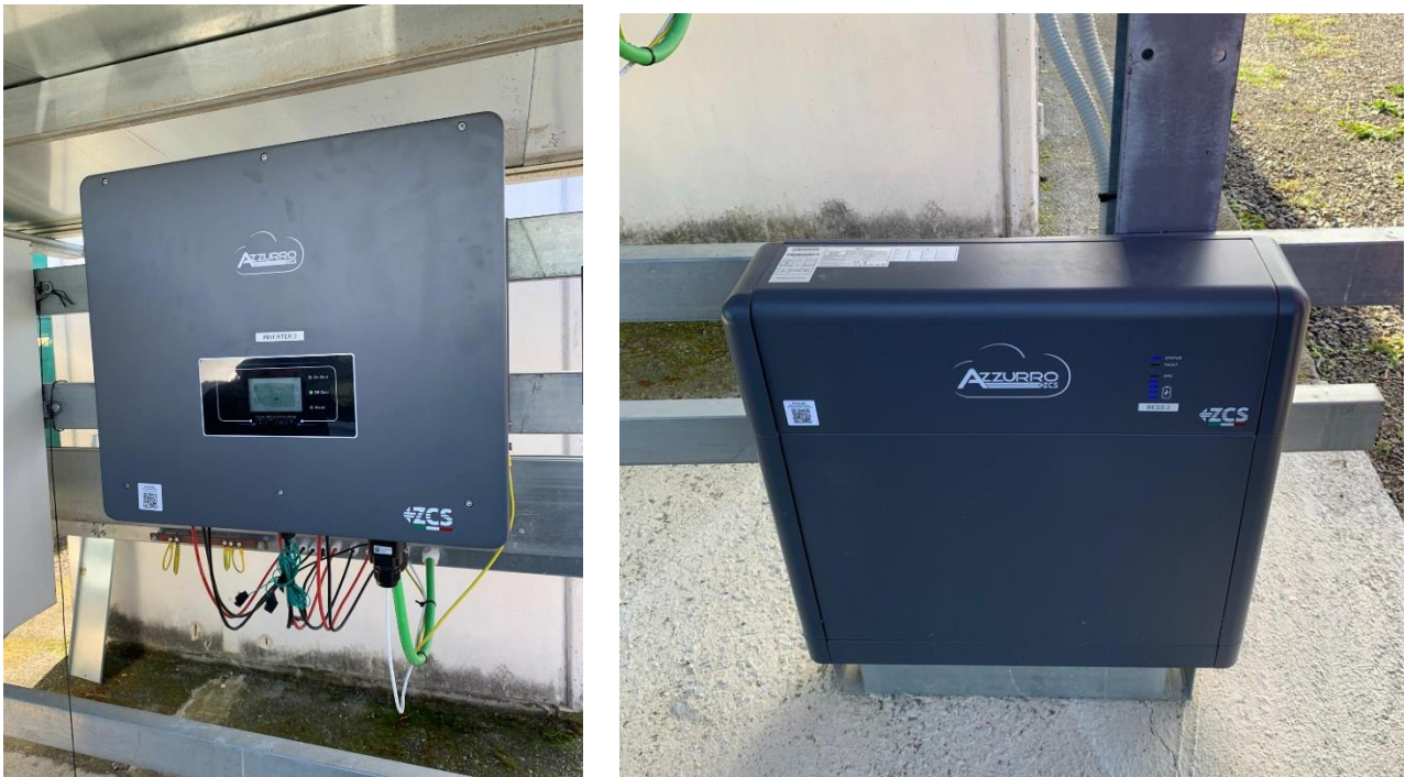
Figura 3- Dettaglio inverter e batterie di accumulo
