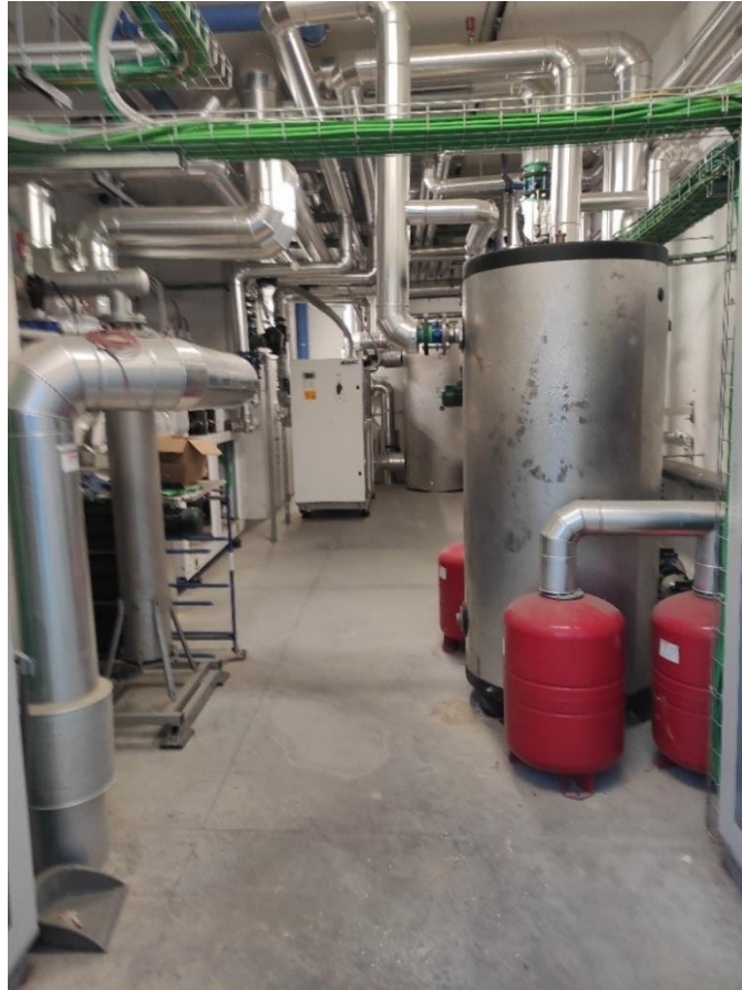
Figura 2 - Centrale termica con pompa di calore acqua-acqua
