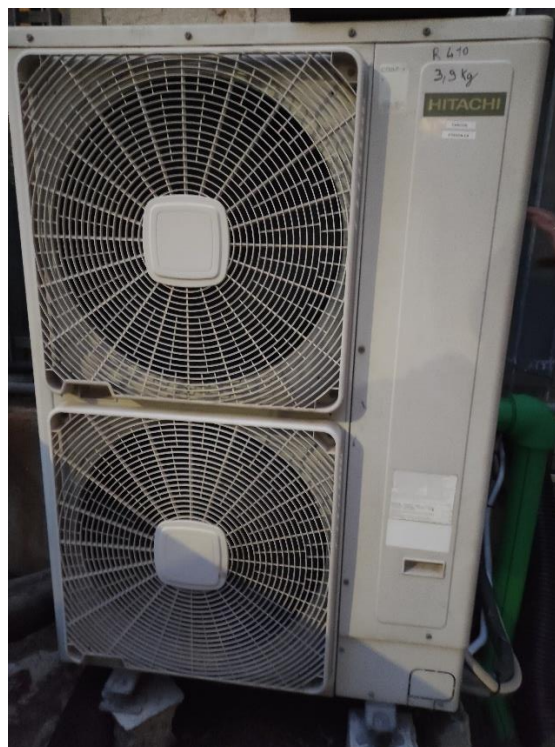
Figura 17 - Unità esterna della pompa di calore aria-aria a servizio di un ufficio
