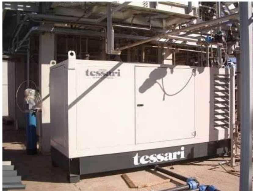
Figura 8. Gruppo elettrogeno da 24 kW elettrici.
