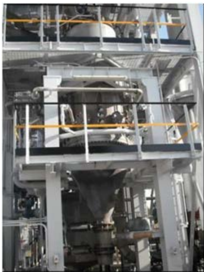
Figura 2. Gassificatore impianto dimostrativo
