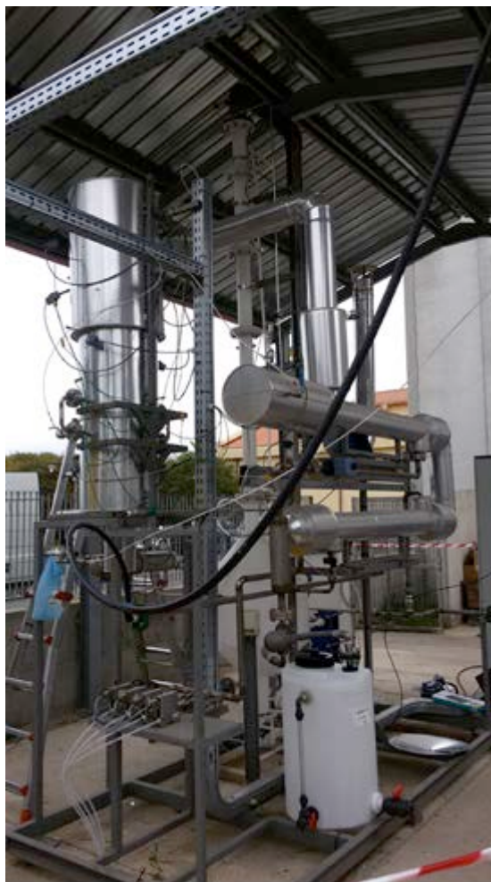
Figure 5 Vista laterale dell'impianto IOSTO
