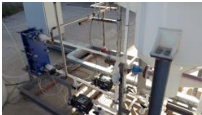
Figure 14 Scambiatore a piastre e pompe rilancio
