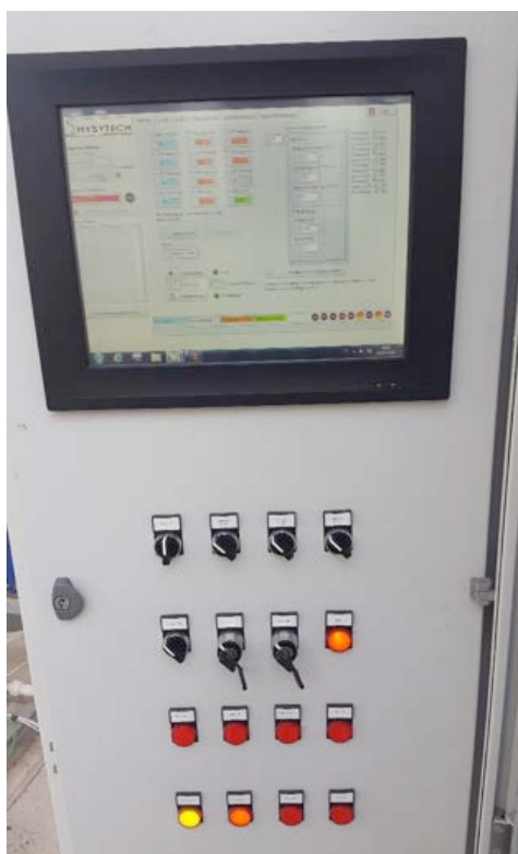
Figure 16 Quadro elettrico di controllo
