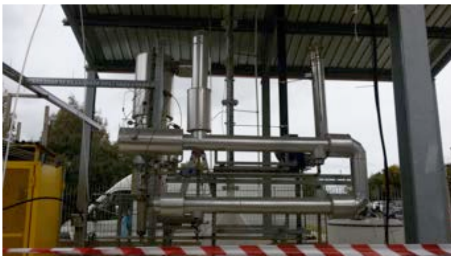
Figure 6 Vista frontale dell'impianto IOSTO
