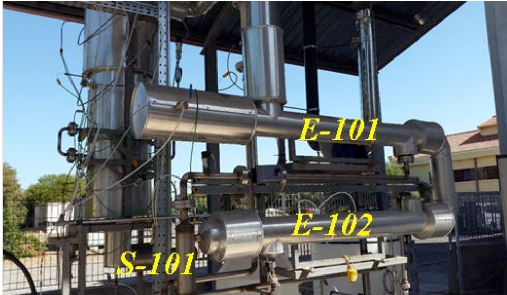
Figure 10 Vista della sezione di disidratazione
