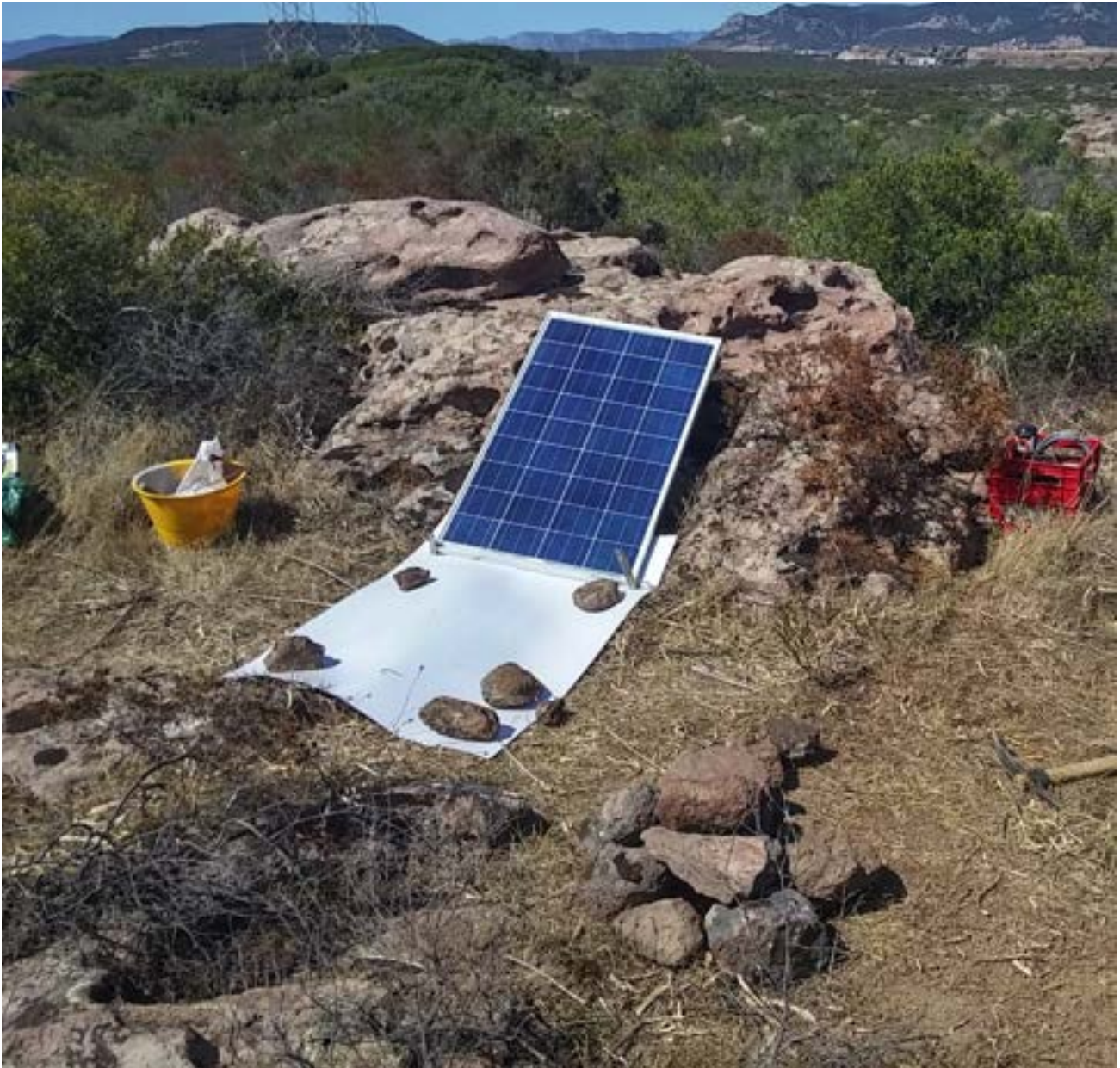
Figura 3.2- Immagine della stazione SU21 installata nei pressi di una ex-miniera nella località Is Urigus.
