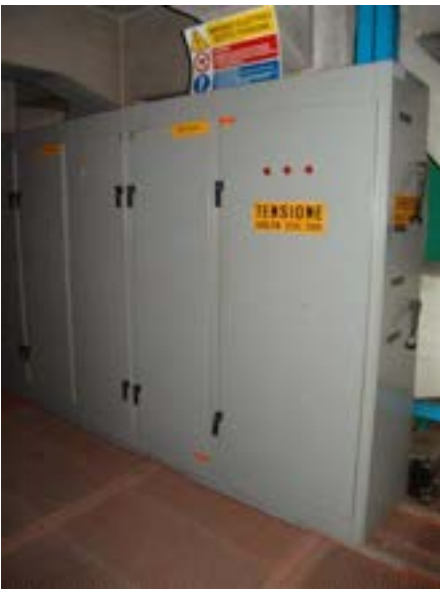
Fig. 25 Quadri d'alimentazione SPES-2 nella posizione originaria
