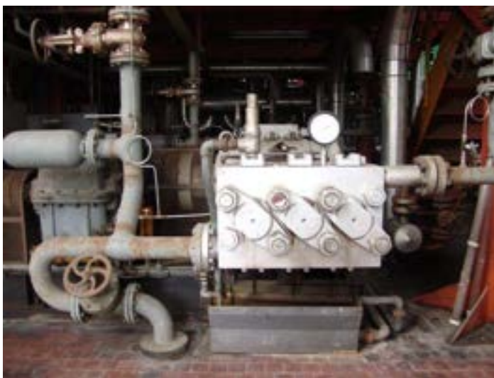
Fig.17 - Pompe per la feedwater (vista da E)
