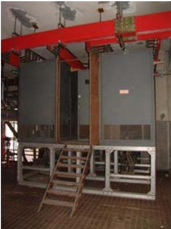
Fig.23 - Gruppo convertitore AC/DC (8MW)
