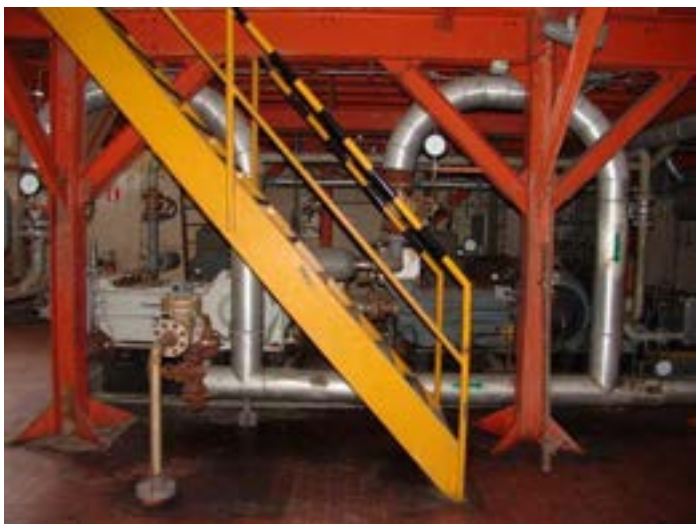
Fig.18 - Pompe per la feedwater (vista da N)
