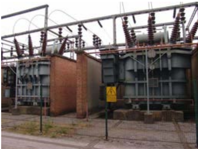
Fig. 16 - Gruppi di trasformazione AT/MT
