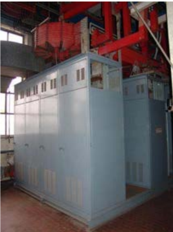
Fig.20 - Gruppo convertitore AC/DC (4MW)
