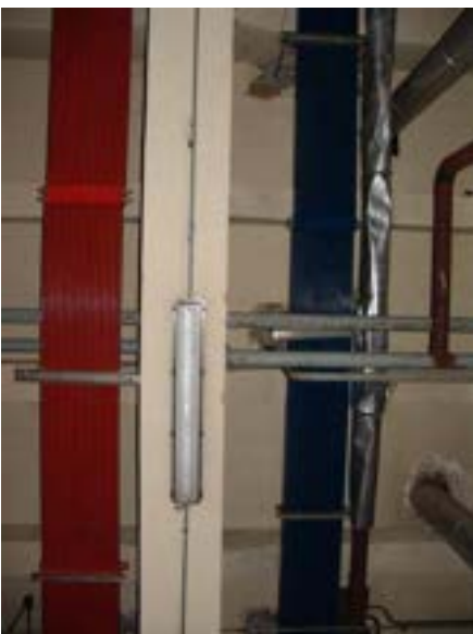
Fig. 26 Sistema di sbarre per alimentazione elettrica barre scaldanti
