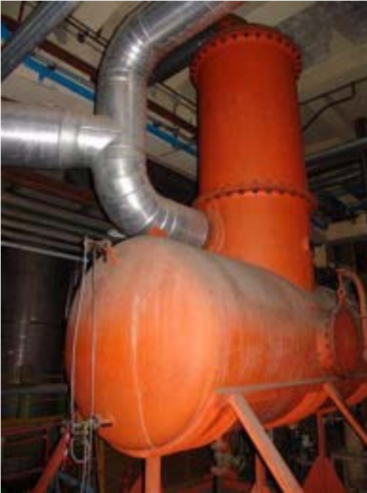
Fig.19 - Separatore per la raccolta del vapore scaricato
