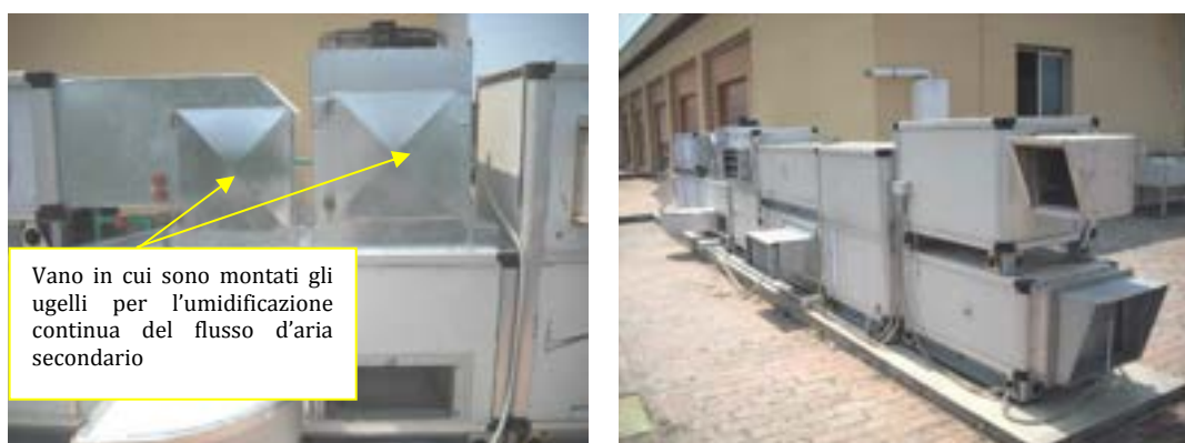
Figura 10: Foto dell'UTA a seguito delle modifiche e dell'introduzione dei due scambiatori di calore
