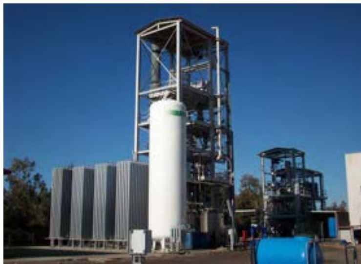
Figura 1.1. La piattaforma pilota Sotacarbo.
