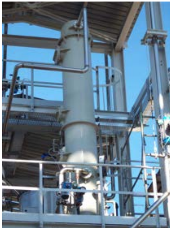
Figura 2.3. Colonna a riempimento di desolforazione a freddo del syngas.
