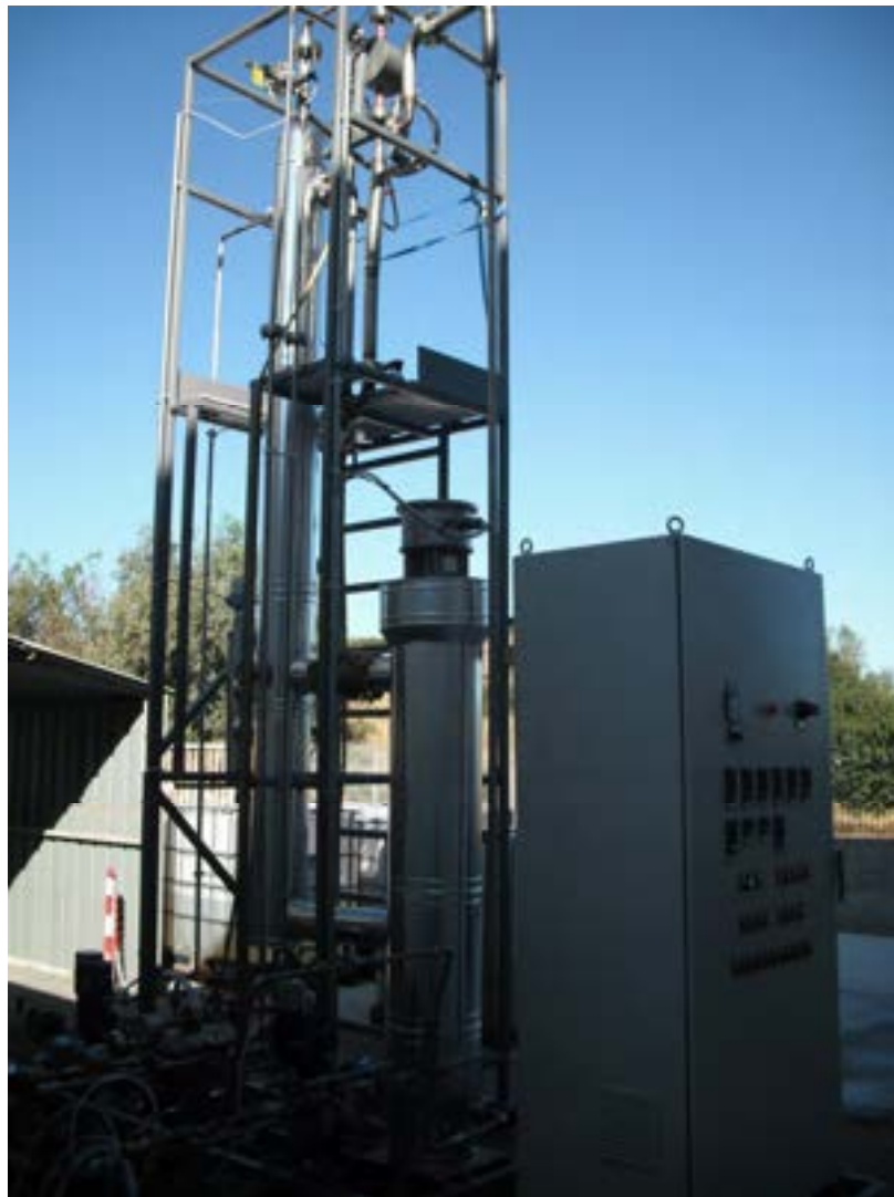
Figura 4.3 Foto dell'intero impianto
