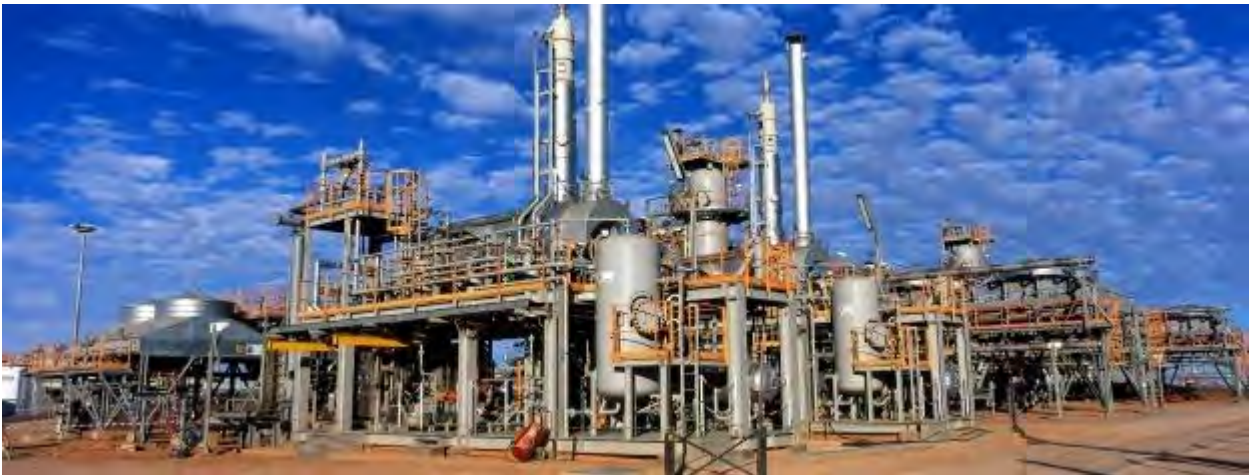
Figura 8.11. L'impianto di In Salah in Algeria 90 .
