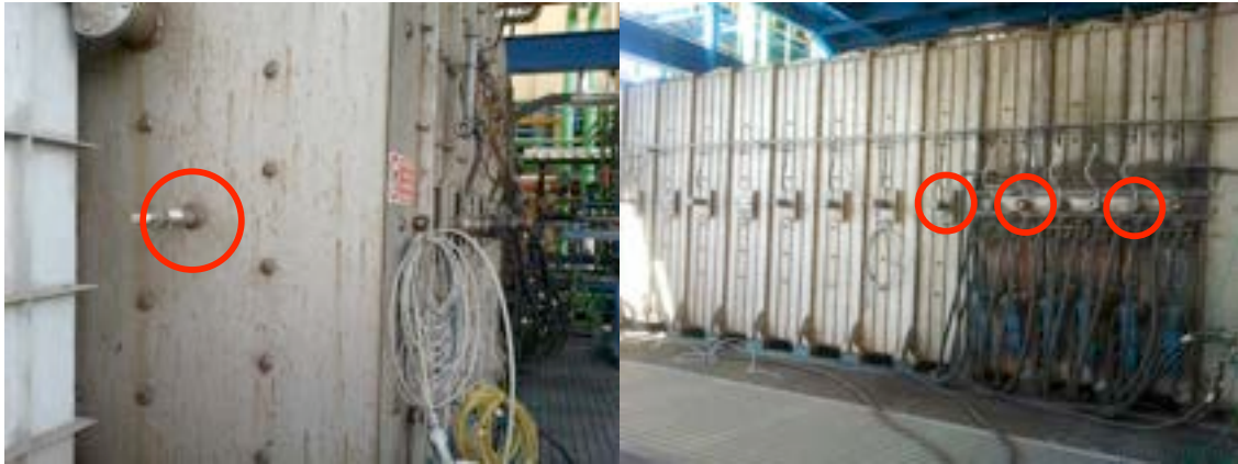
Figura 7 Bocchelli dedicati alle sonde ODC, cerchiati in rosso
