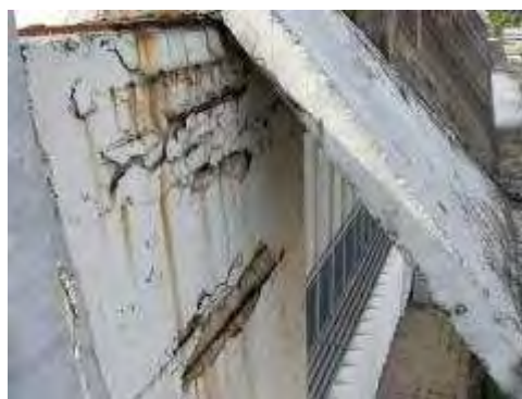
Figura 1.6. Effetti della carbonatazione naturale di manufatti di calcestruzzo
