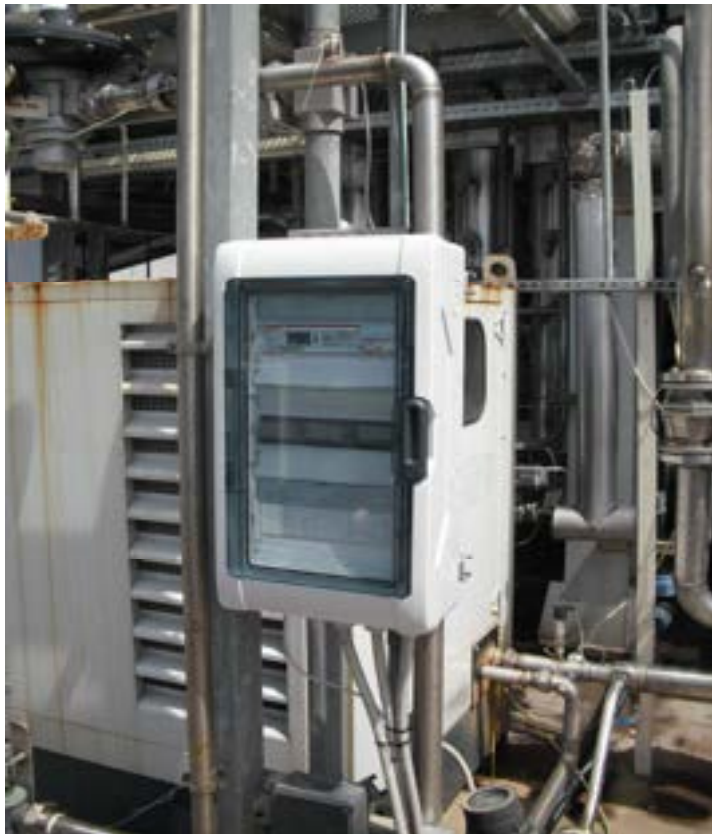
Figura 2.4.2.1: Contatore di kW elettrici prodotti dal motore
