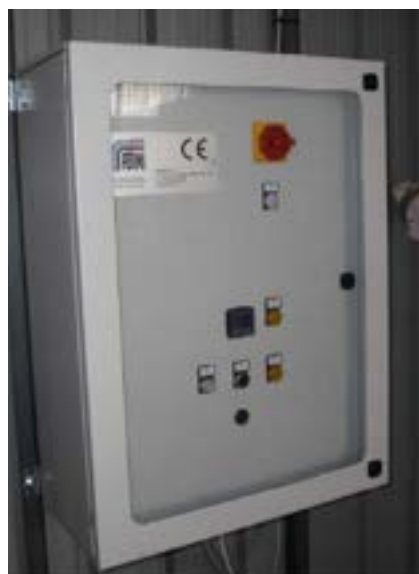
Figura 2.3.2.2: Quadro di gestione dello scambiatore elettrico preriscaldamento ammine
