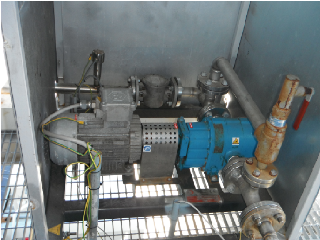
Figura 2.6.2.1: Nuovo compressore a servizio della sezione di trattamento a caldo
