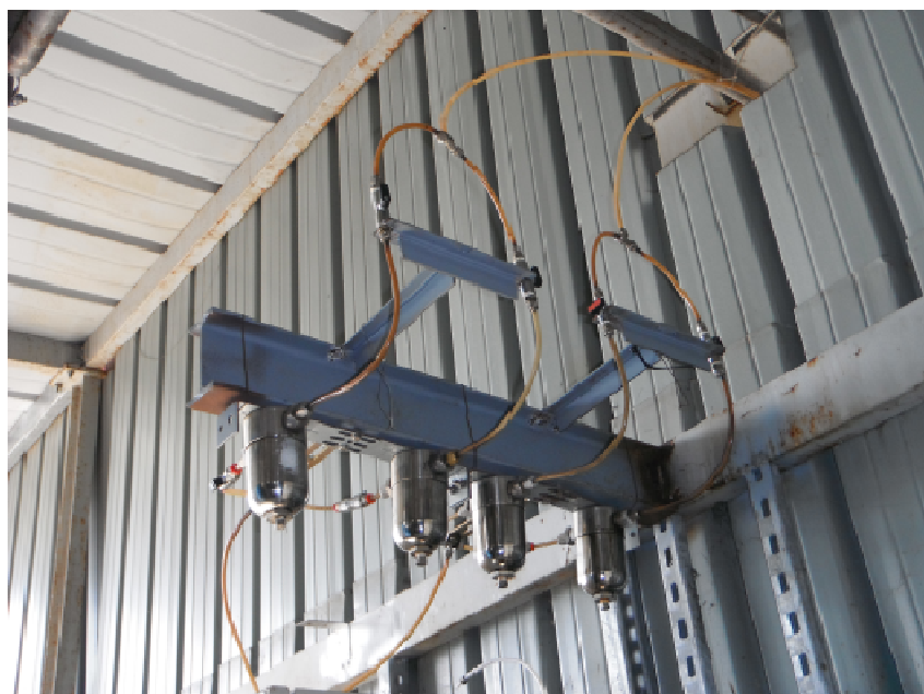
Figura 2.5.2.2: Elementi filtranti installati nel sistema di campionamento degli analizzatori O 2
