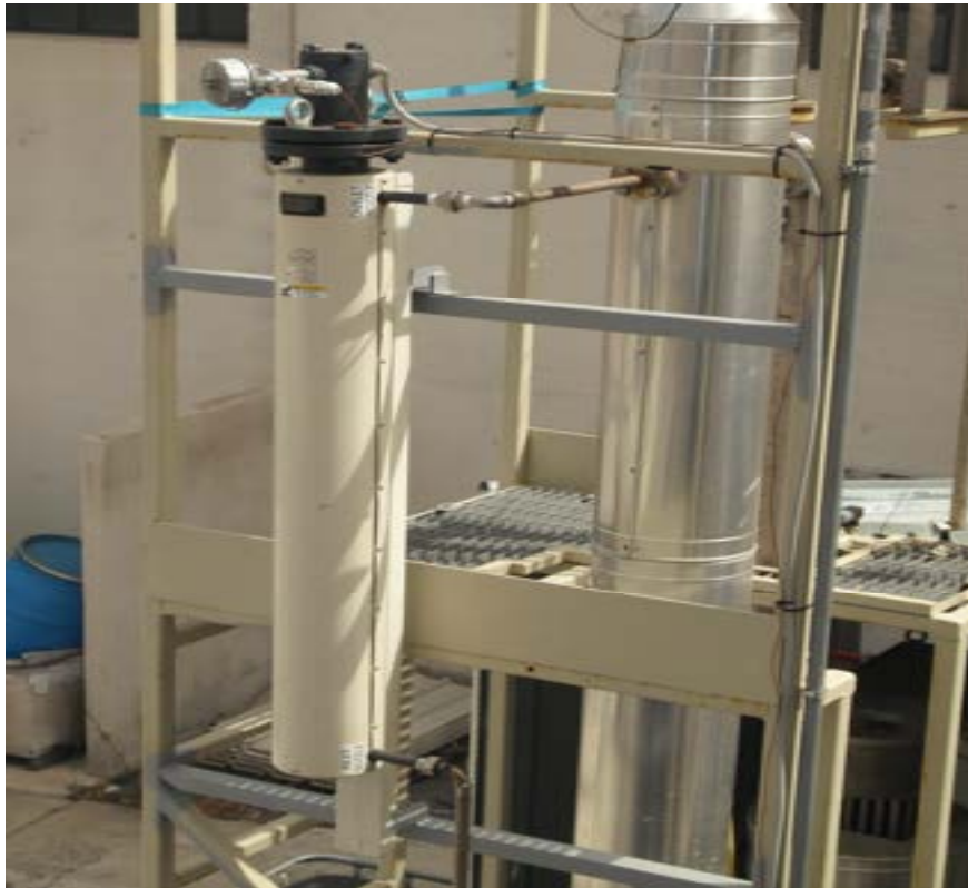
Figura 2.5.1: scambiatore elettrico preriscaldamento ammine
