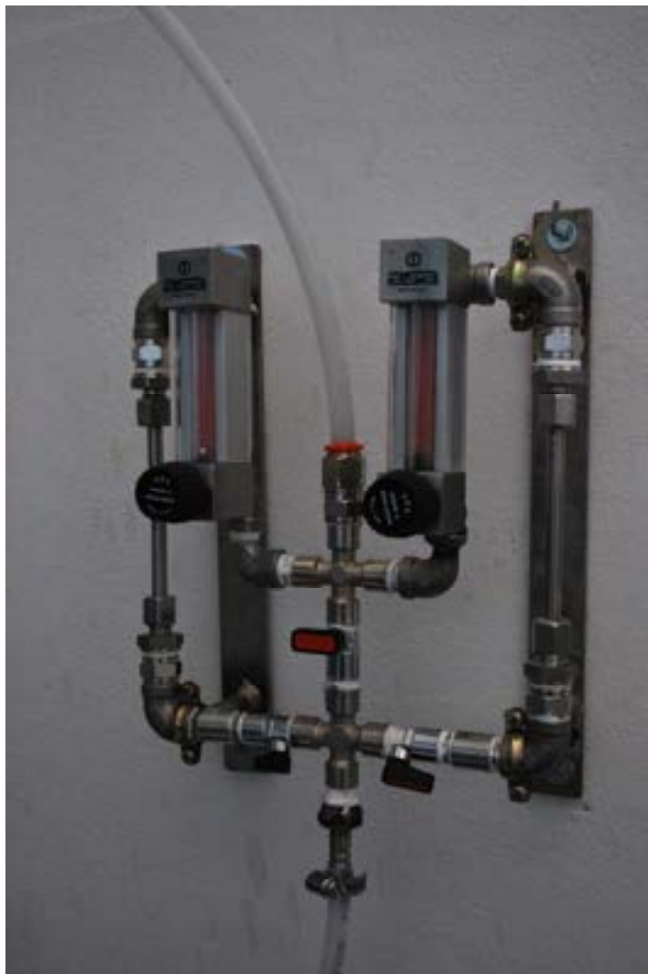
Figura 2.19. Flussimetri per la misura della portata di CO 2 rigenerata.
