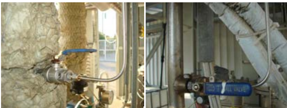
Fig. 7 e 8 – Prese di campionamento inserite nei punti di passaggio del gas dell’impianto pilota
