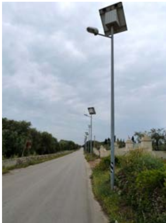
Figura 5.6 – Lampioni fotovoltaici presso Torchiarolo (Brindisi)
