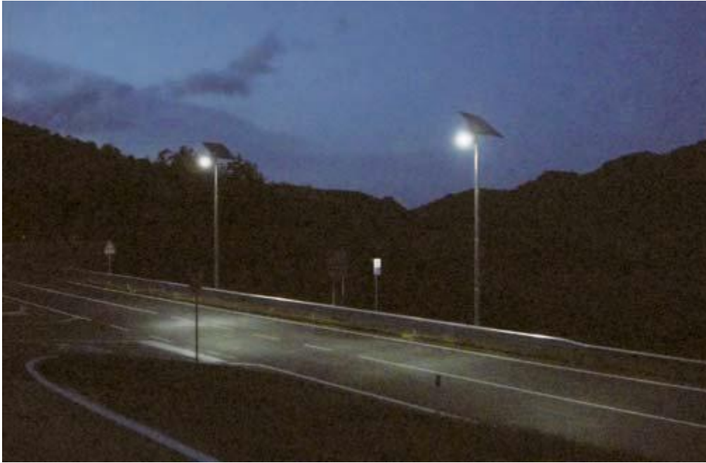
Figura 5.5 – Lampioni Fotovoltaici presso variante di Selvanizza (Comune di Palanzano)
