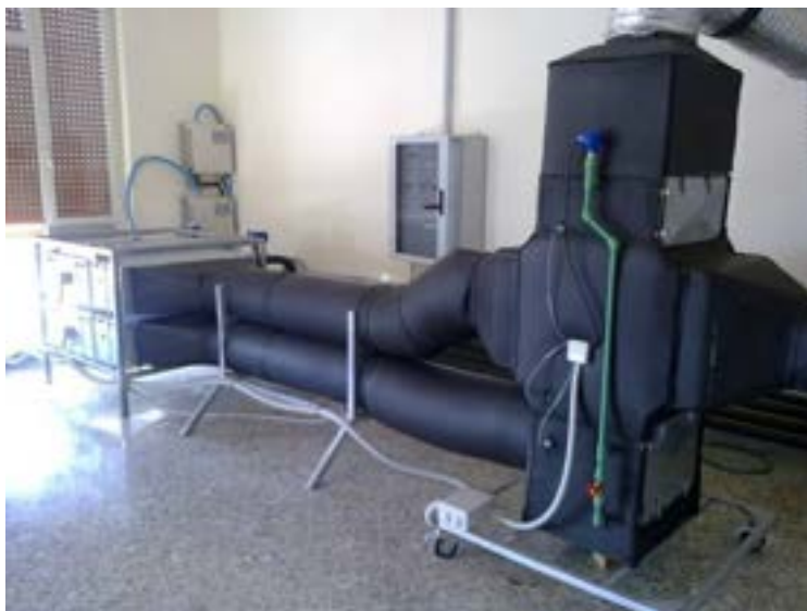
Figura 2 Foto della cella di test per lo scambiatore di calore aria-aria in esame
