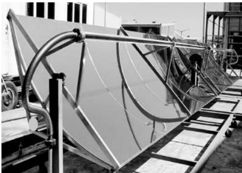
Figura 54 Dettaglio del campo solare dell'impianto [24]
