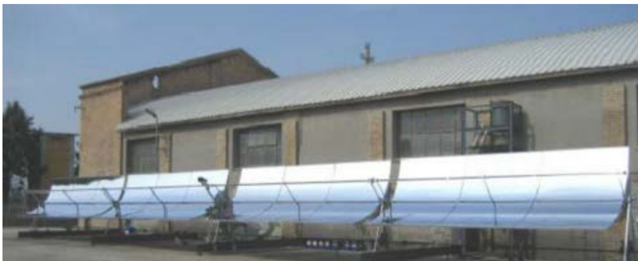
Figura 51 Particolare del campo solare dell'impianto di solar cooling di Gambettola (FC)
