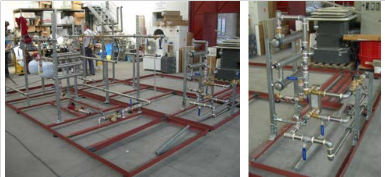
Foto dell'impianto di prova durante alcune fasi dell'assemblaggio idraulico
