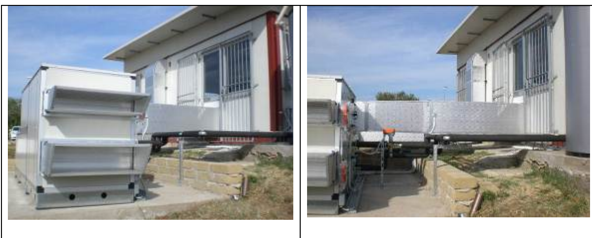
FIGURA 1.31: UTA LORAN, presa aria esterna, espulsione aria ambiente e canale ripresa aria
