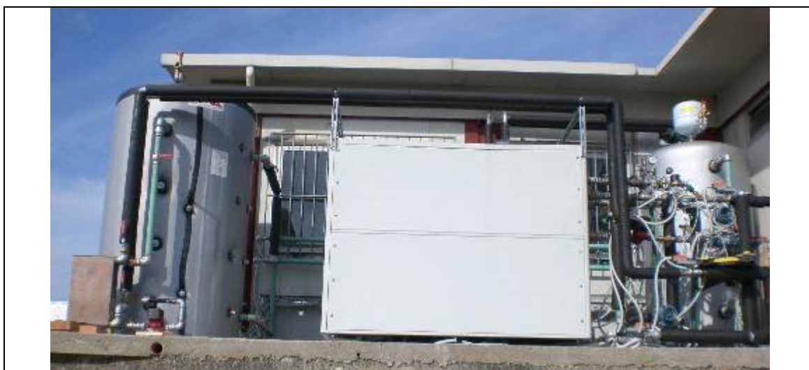
FIGURA 1.40: Serbatoi inerziali: lato Sinistro accumulo caldo, lato Destro accumulo freddo
