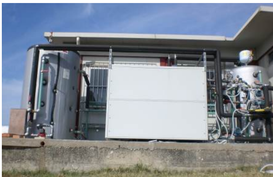
FIGURA 1.3: Pompa di calore a CO 2 prototipo ENEA installata presso il Centro Ricerche di Casaccia
