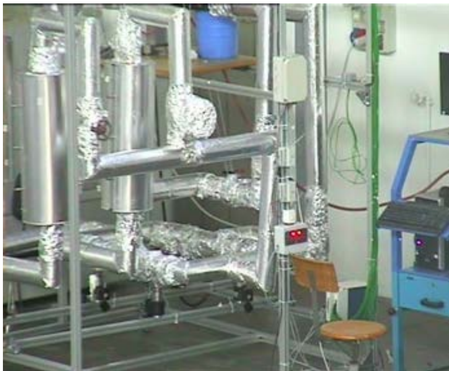
Figura 1- Scorcio dell'impianto ATES in Enea Casaccia (Roma)
