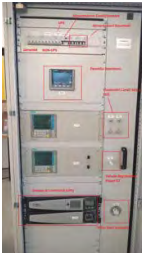
Figura 4.3. Quadro analizzatore Siemens.
