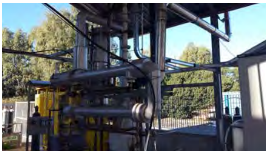
Figura 2.1. Vista frontale dell'impianto IOSTO.
