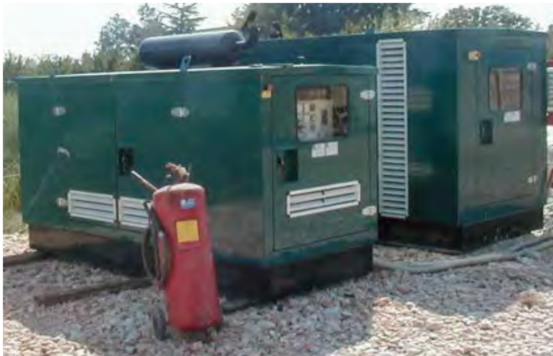
Figura 9 Esempio di generatori.
