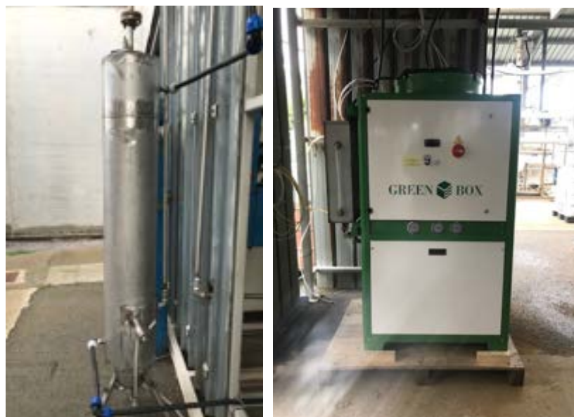
Figura 19. Separatore di condensa incamiciato (sinistra) e chiller (destra)
