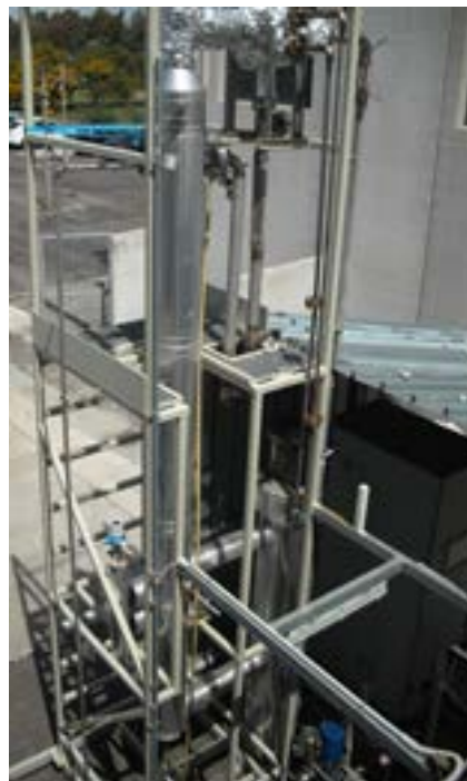
Figura 10. Unità di rigenerazione delle ammine.
