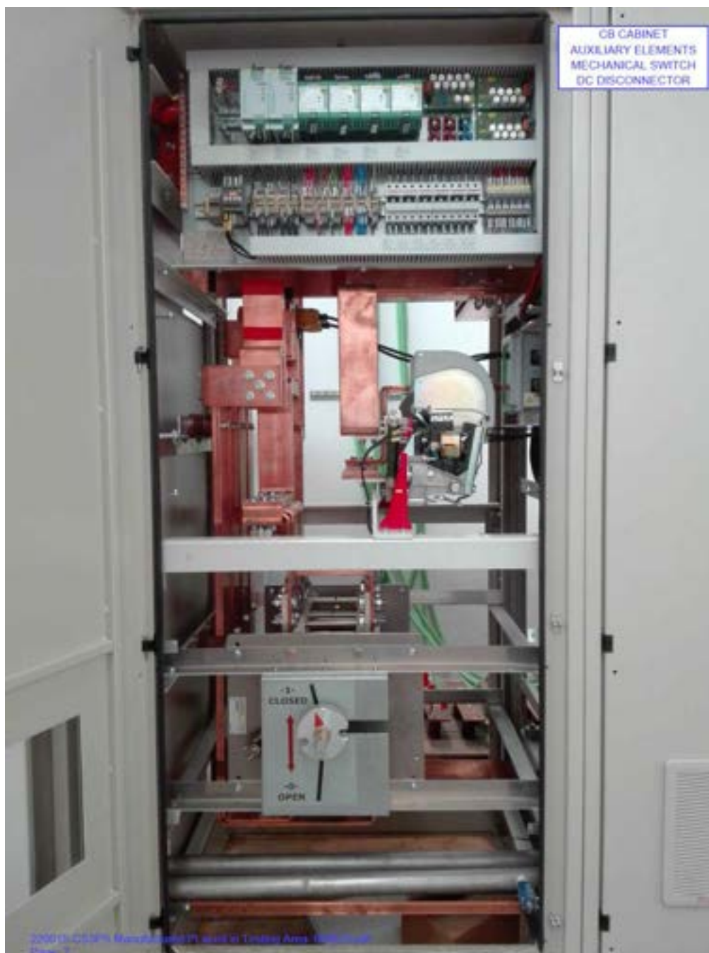
Figura 19 – dettaglio del sezionatore DC.
