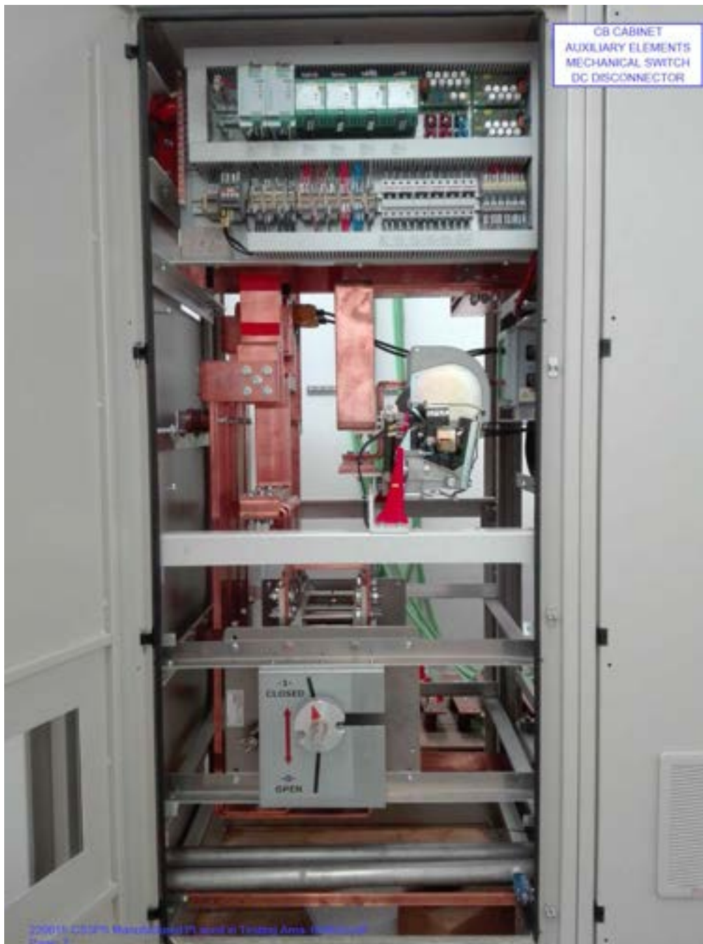
Figura 2 – dettaglio del sezionatore DC.
