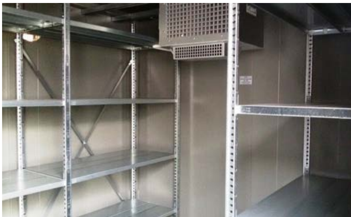
Figura 5. Box stoccaggio sicurezza batterie: interno lato lungo (storage celle e batterie movimentabili a mano)
