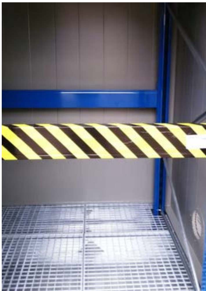
Figura 6. Box stoccaggio sicurezza batterie: particolare lato corto (posizionamento batterie grandi con transpallet)
