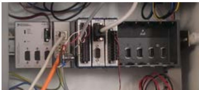
Figura 3. Il Controllore dell'impianto (Crio)
