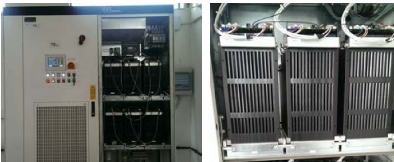
Figura 2. Il Sistema di accumulo utilizzato nelle prove.
