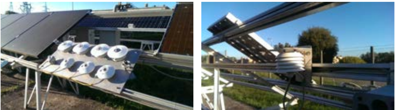
Figura 5. La stazione meteo
