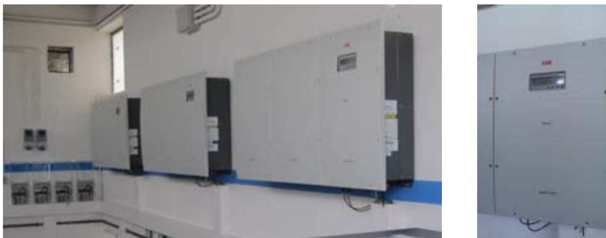
Figura 7. I tre inverter fotovoltaici ABB-REACT-UNO 4.6 TL (a dx l'unità riferita alla fase 2).
