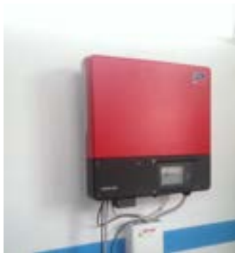
Figura 4. L'inverter fotovoltaico (3 kW) dell'impianto monofase.
