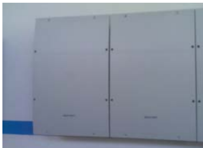
Figura 8. Il Sistema di accumulo ABB-REACT-BATT-AP1 (unità da 4 kWh riferita alla fase L2).
