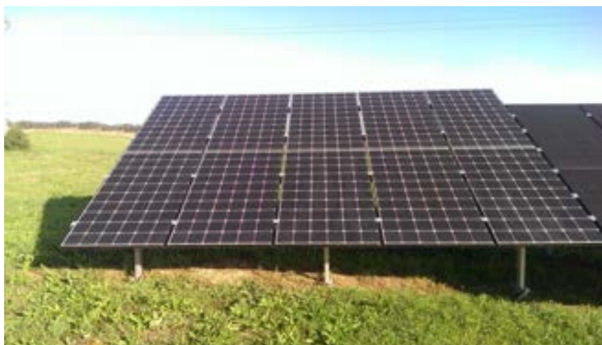
Figura 1. Il campo fotovoltaico (3,25 kW) dell'impianto monofase.
