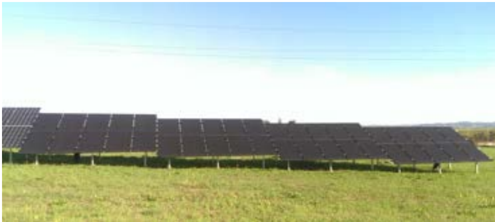
Figura 6. Il campo fotovoltaico (12 kW) dell'impianto trifase.
