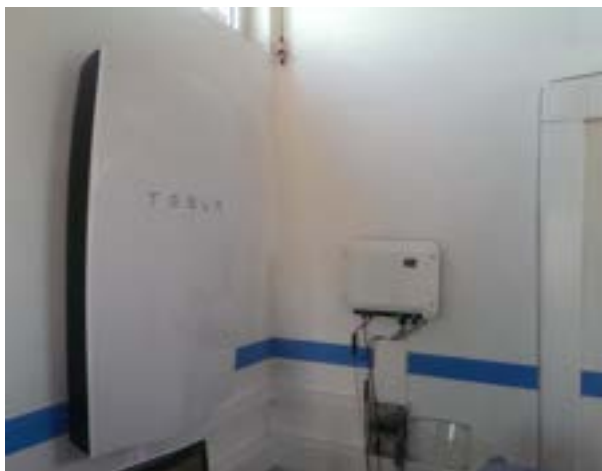
Figura 5. Il sistema di accumulo (2,5 kW 6,4 kWh) dell'impianto monofase.
