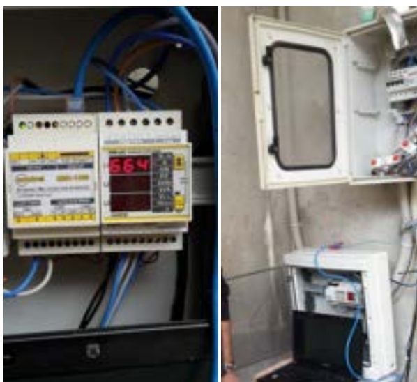
Figura 131: particolare fase di installazione del quadro di misura assemblato per il monitoraggio della pompa di calore
