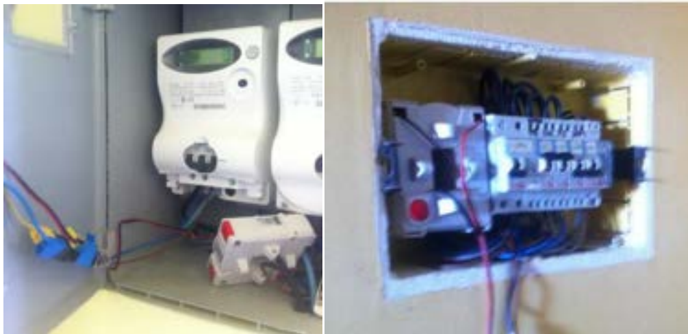
Figura 132: particolare delle fasi di installazione degli strumenti di misura a valle del contatore Selis e a valle dell'interruttore di alimentazione dello scaldabagno.
