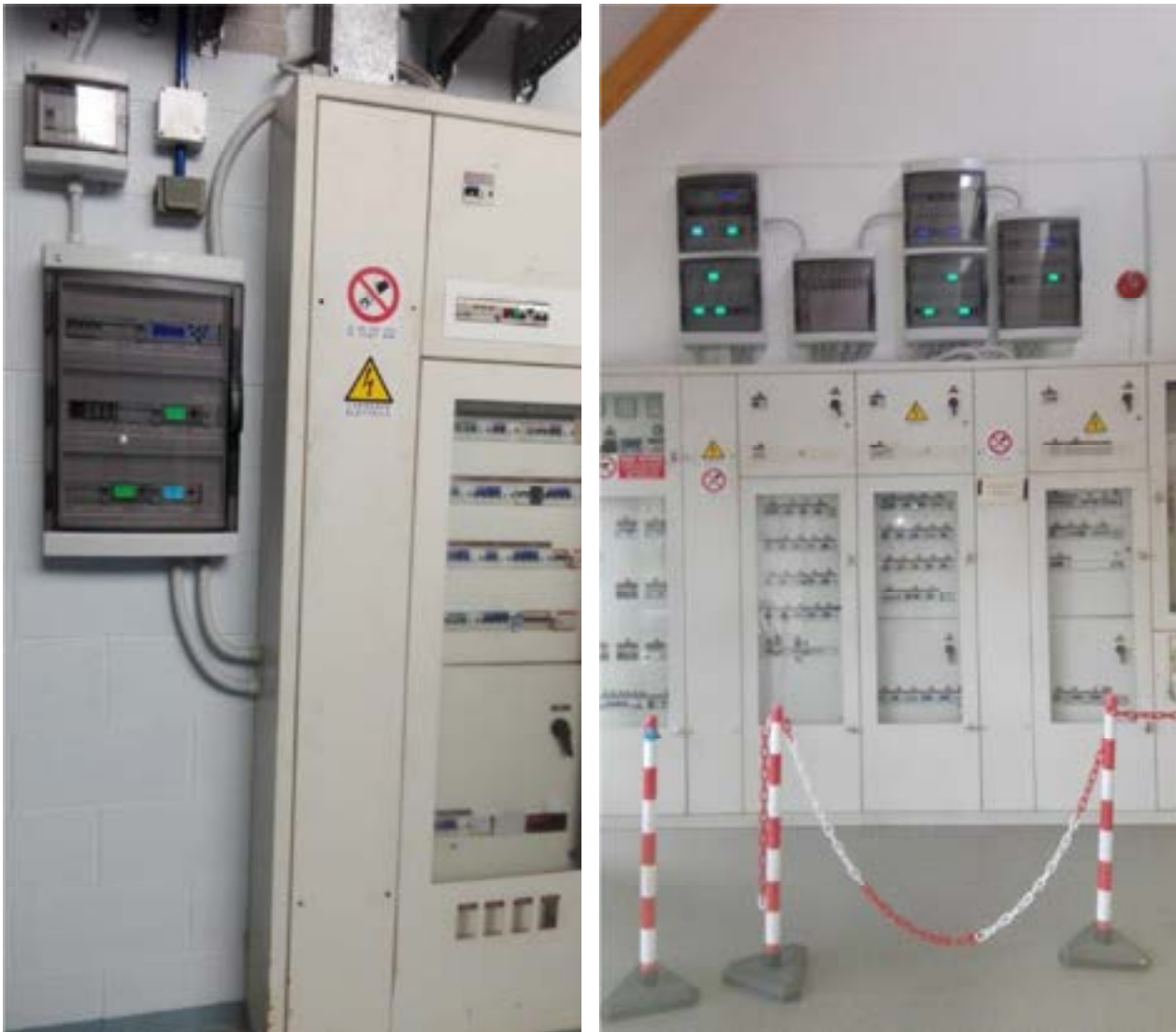
Figura 2.80 Sistema di monitoraggio installato
