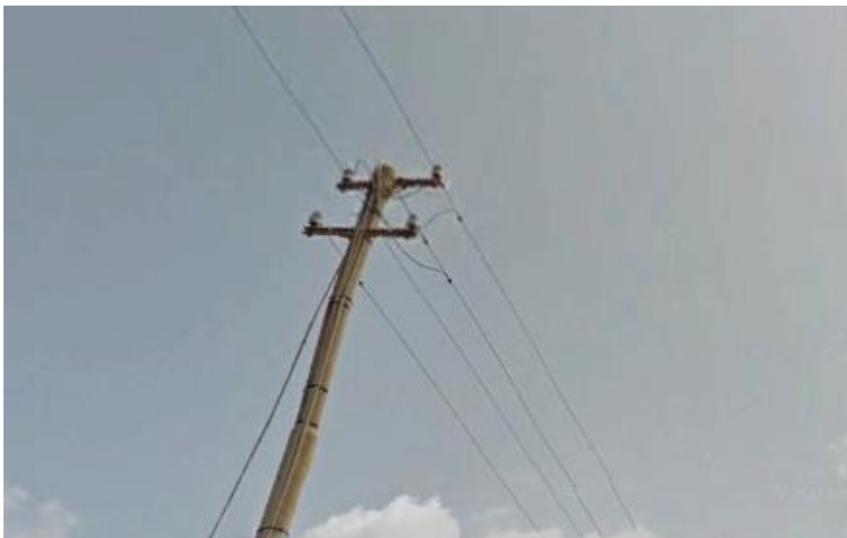
Figura 38. Particolare di linea con conduttori di rame nudo aerei in BT nella zona centrale dell'isola di Lampedusa a NORD-OVEST rispetto al centro abitato.
