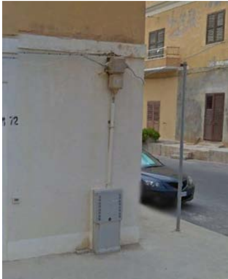
Figura 39. Cassetta di derivazione stradale in una via del centro urbano di Lampedusa.
