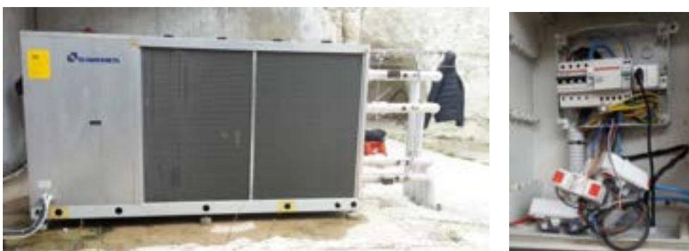
Figura 27 Pompa di Calore a servizio dell'albergo e quadro elettrico
