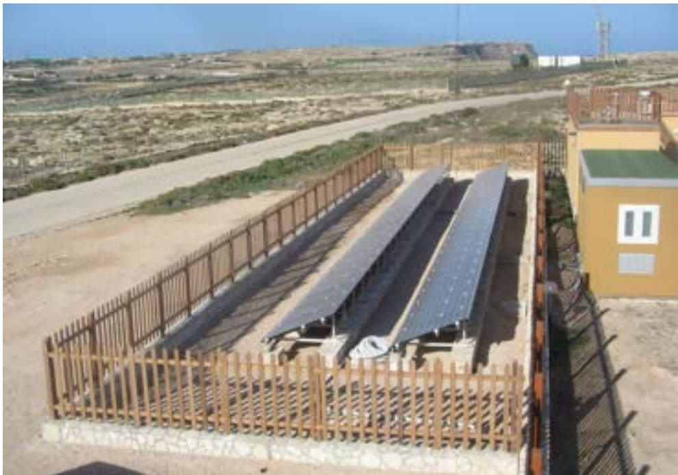
Figura 156. Vista dell'impianto fotovoltaico che alimenterà il sistema a pompa di calore da testare durante le sperimentazioni.
