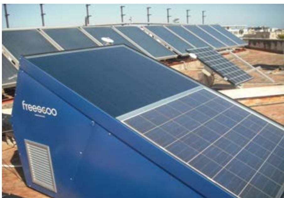
Figura 154. Foto del prototipo freesco attualmente installato presso il Laboratorio solare del DEIM dell'Università di Palermo.
