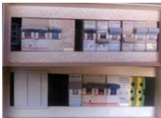
Figura 26. Quadri elettrici della villetta.
