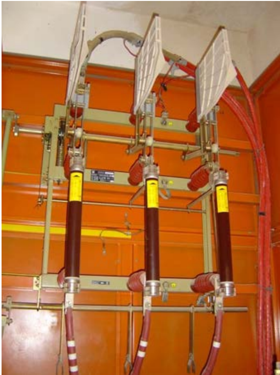
Figura 35. Interruttori MT in aria a 10kV all'interno di una cabina di distribuzione SE.LI.S.
