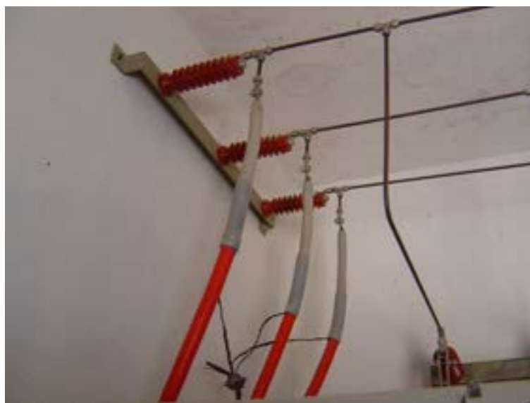
Figura 34. Derivazione in cavo MT da sbarre a 10kV all'interno di una cabina di distribuzione SE.LI.S.
