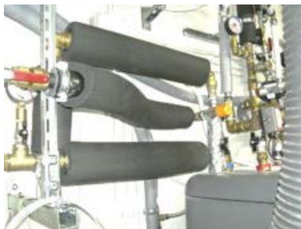
Figura 7. Tubi rettilinei termicamente isolati in corrispondenza dei misuratori di energia termica nei circuiti idronici.
