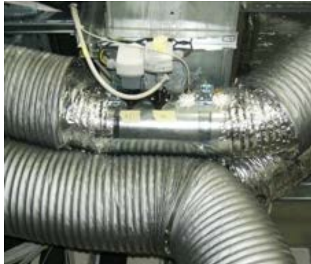
Figura 5. Sensori di temperatura, umidità relativa, concentrazione di CO 2 e composti organici volatili su canale dell'aria in impianto di ventilazione meccanica (canale principale di aria di ripresa).
