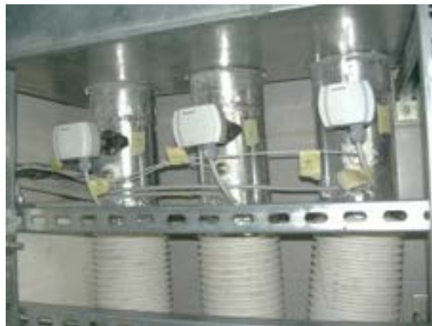
Figura 6. Sensori di temperatura e umidità relativa in canali d'aria all'uscita dello scambiatore di calore interrato
